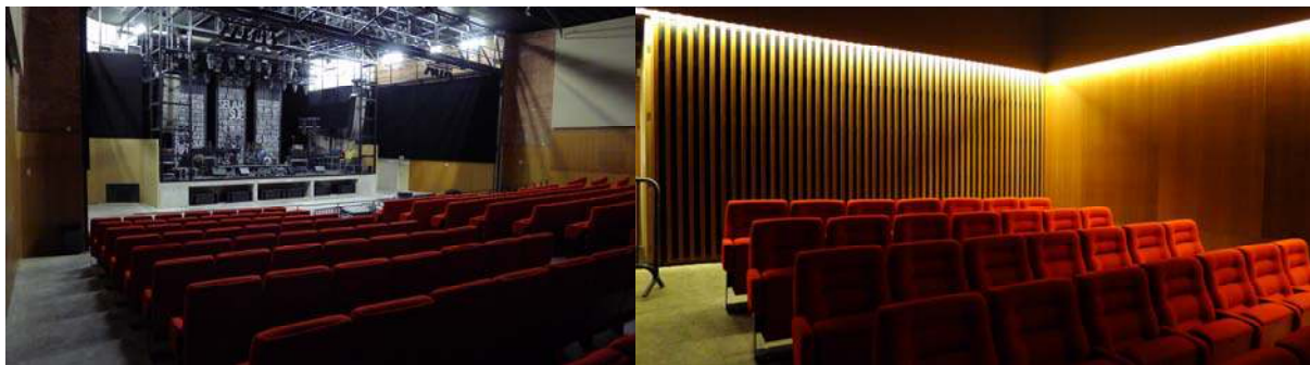
Verdringingsventilatie met inblaasplenum achteraan
