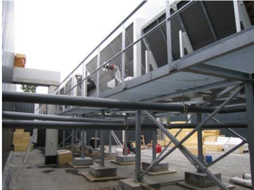
Koelgroepen op dak met drycoolers voor freecooling
