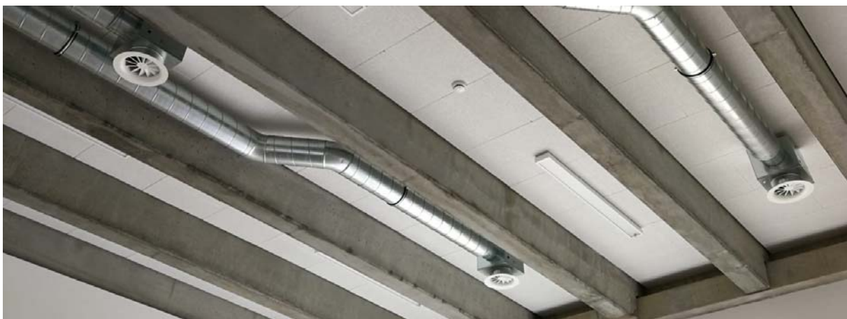
Ventilatie klaslokalen met ribbenvloer
