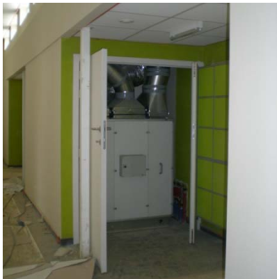
Opstelling luchtgroep in technische kast
